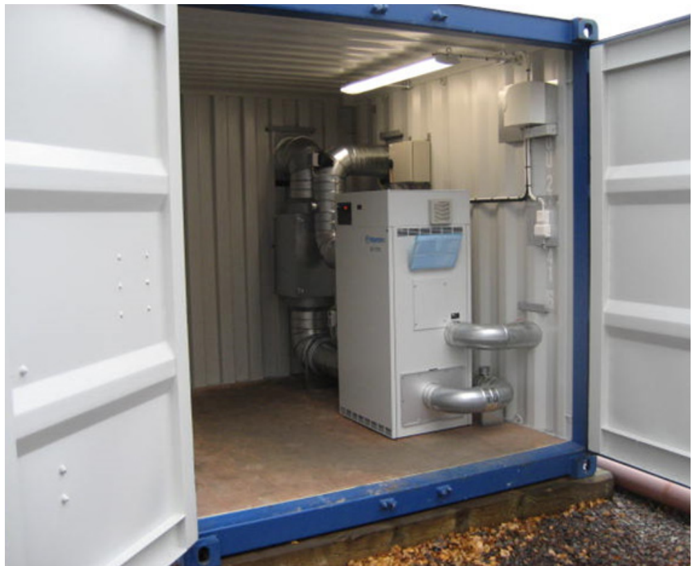
Exempel på installation av avfuktare i container
