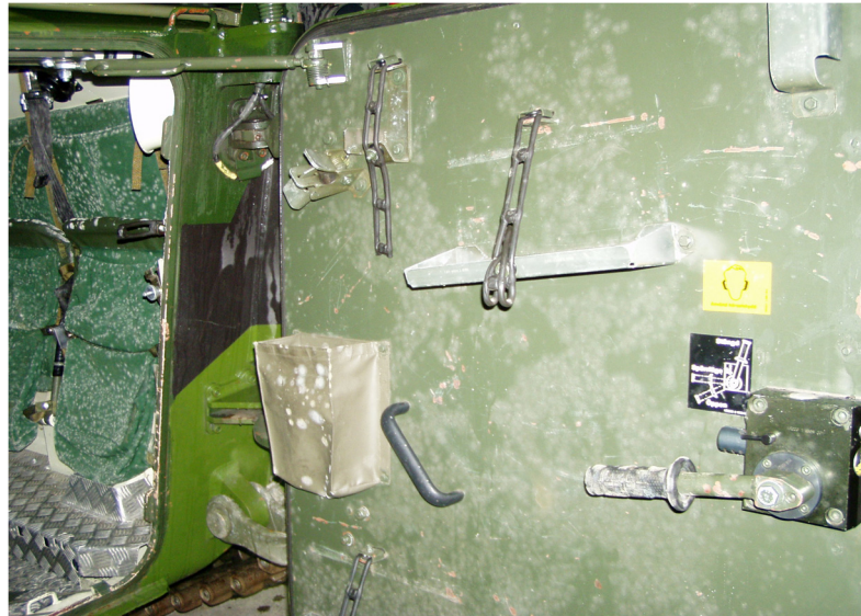
Bild 16. Mögel i stridsfordon som man glömt att ansluta till avfuktning.
