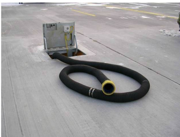
Bild 70. Fast avfuktning på flygfält
