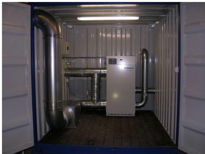
Bild 83. Bypass kanal för torrluft
