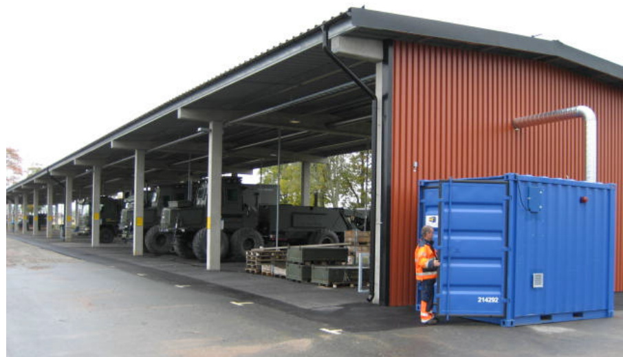
Bild 65. Container med avfuktningsutrustning
