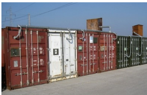
Bild 18. Dynamiskt avfuktade containrar.
